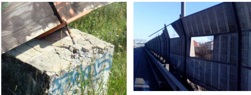
Рис. 4 – поврежденные шумозащитные экраны
