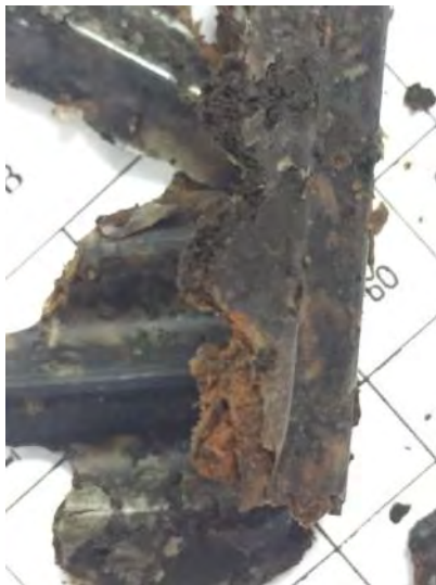
Рис. 2. Образование осадка на пластинчатом теплообменнике водогрейной котельной
